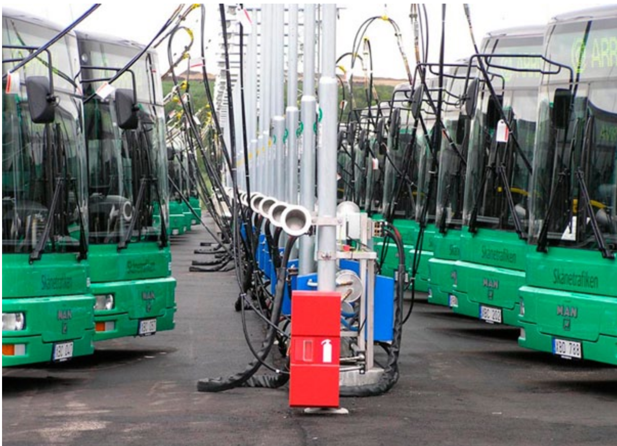
Tankning av biogasbussar, med uppkoppling till det lokala gasnätet. Foto: NSR
